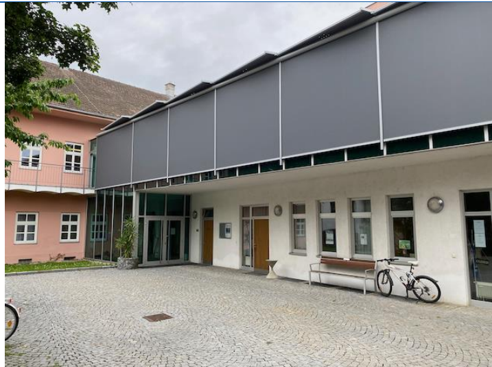
Foto: Beschattung von außen
