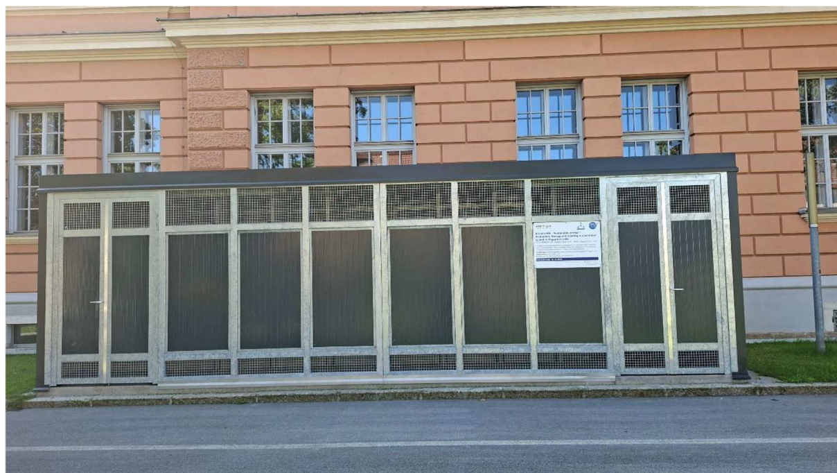
Abbildung 13 - Batteriespeicher inkl. Einhausung, ©EKG
